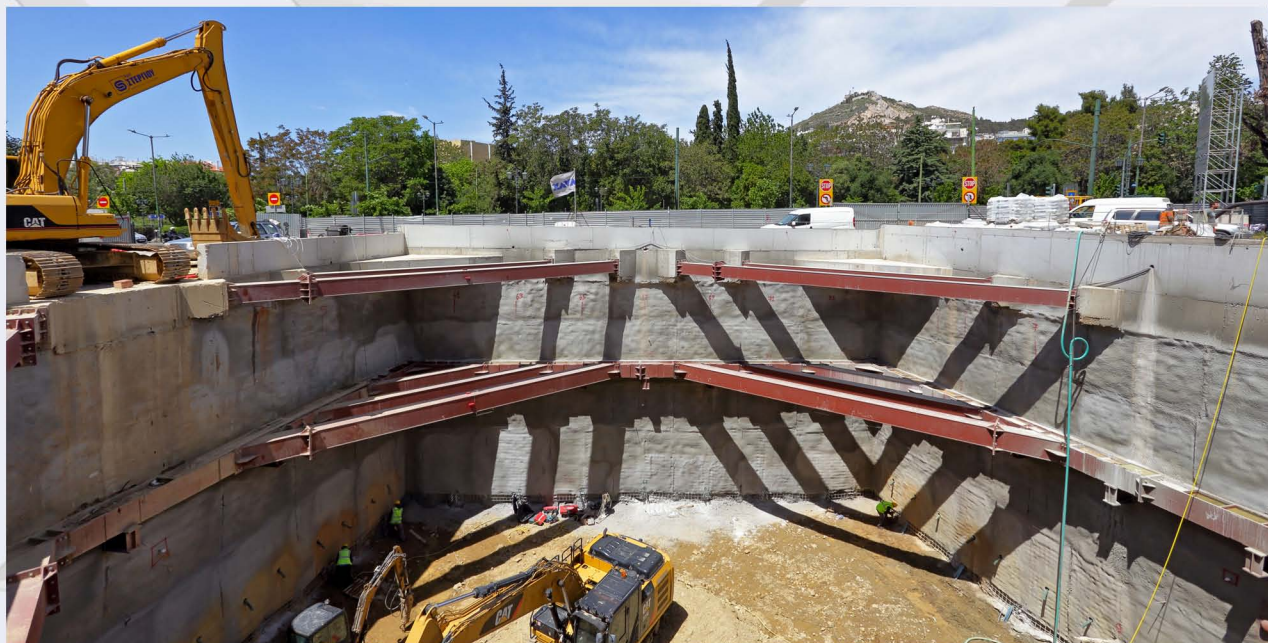
Φρέαρ ΔΙΑΚΛΑΔΩΣΗΣ ΕΥΑΓΓΕΛΙΣΜΟΥ.
